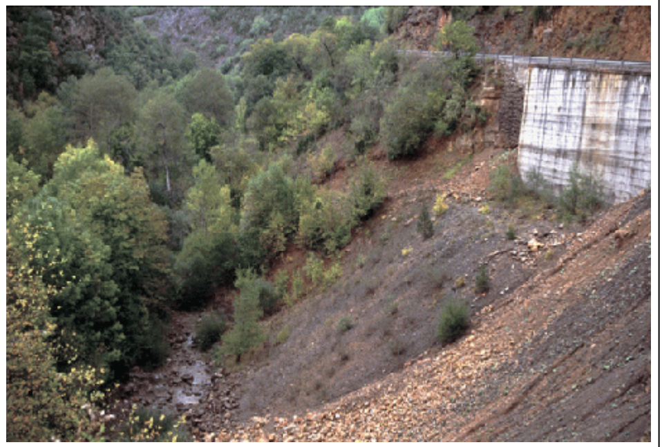
Foto 3.- Las obras de defensa de la carretera a menudo han destruido la vegetación de ribera y han facilitado indirectamente los procesos erosivos.
