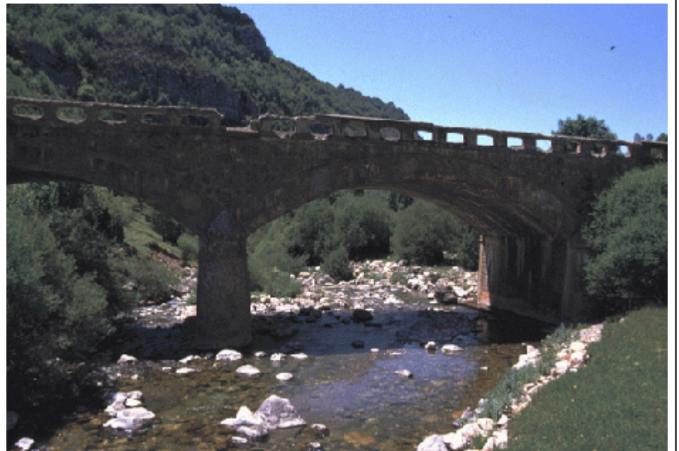
Foto 2.- Puente de la N-260 sobre el Isábena, aguas arriba de la confluencia con el río Blanco. Su estado de conservación es deficiente.
