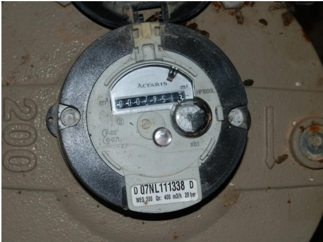
Foto 5. Contador control de caudal en Pozo 2 de Mora d'Ebre.
