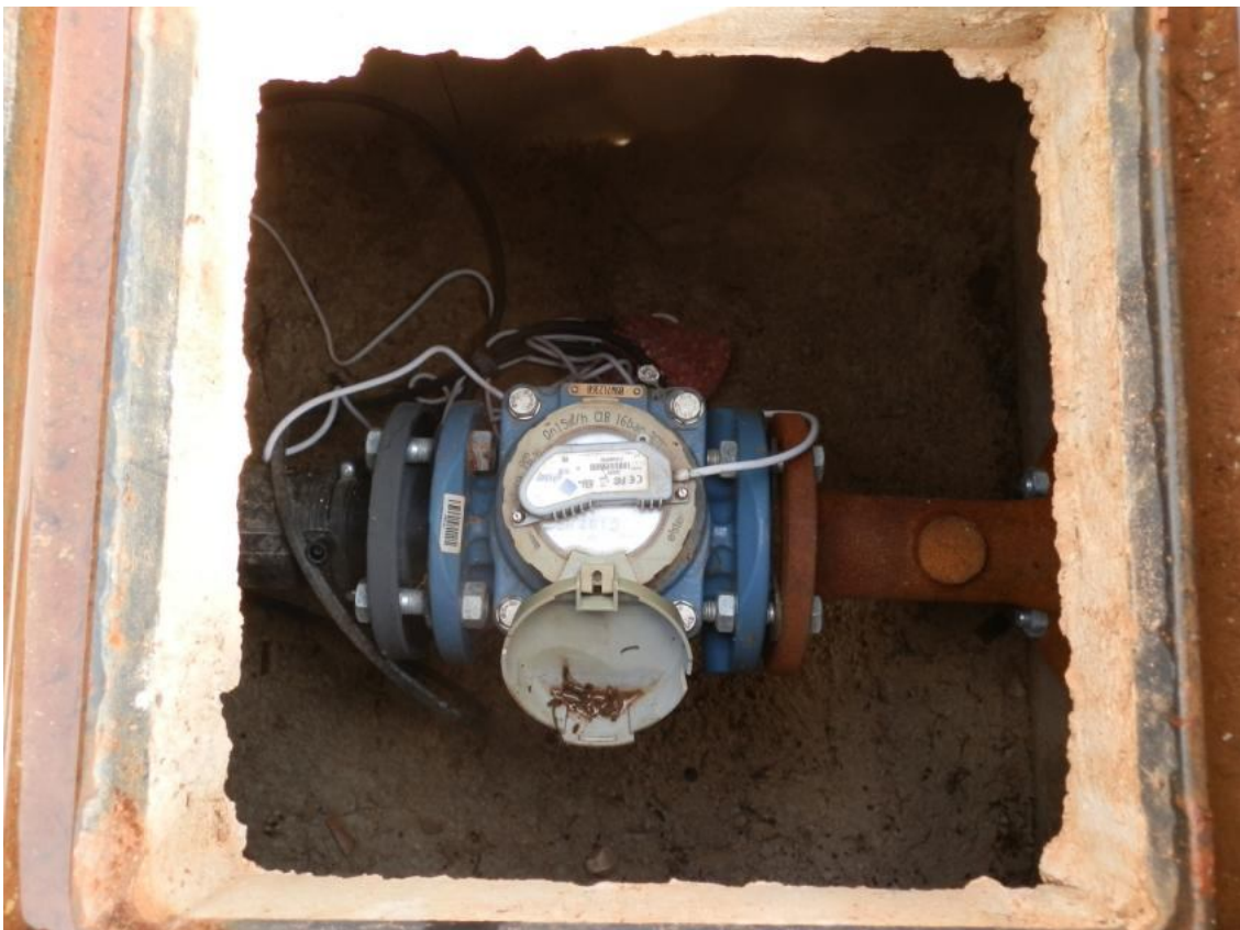
Foto 4. Contador control de caudal
